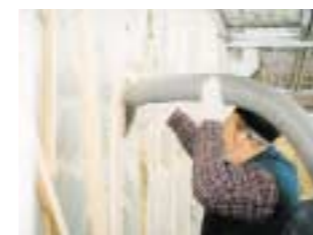
Seegrass kann als Dämm-Material eingblasen werden.
